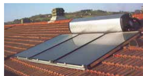
Impianto solare termico
